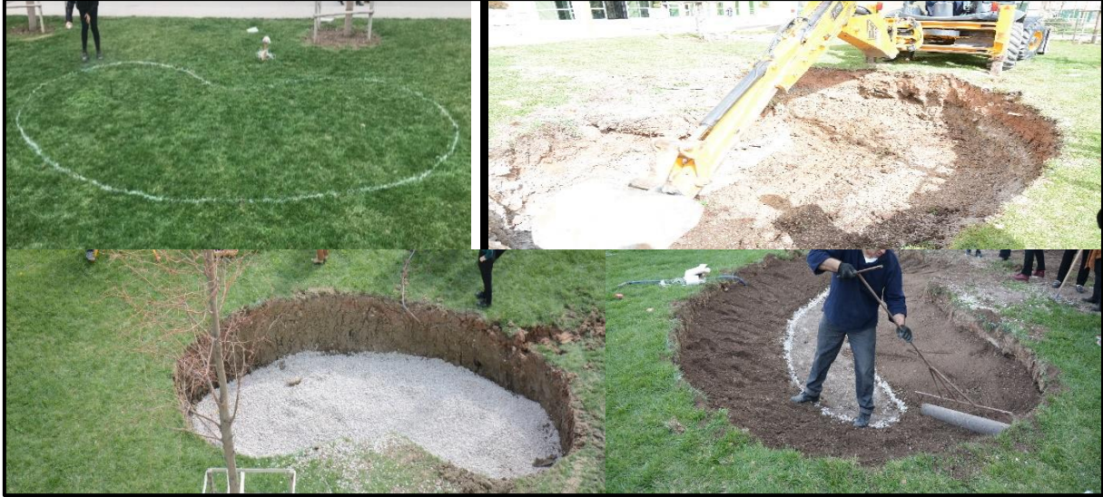
Şekil 10 Yağmur bahçesi uygulaması (ÇŞİDB, 2018)
